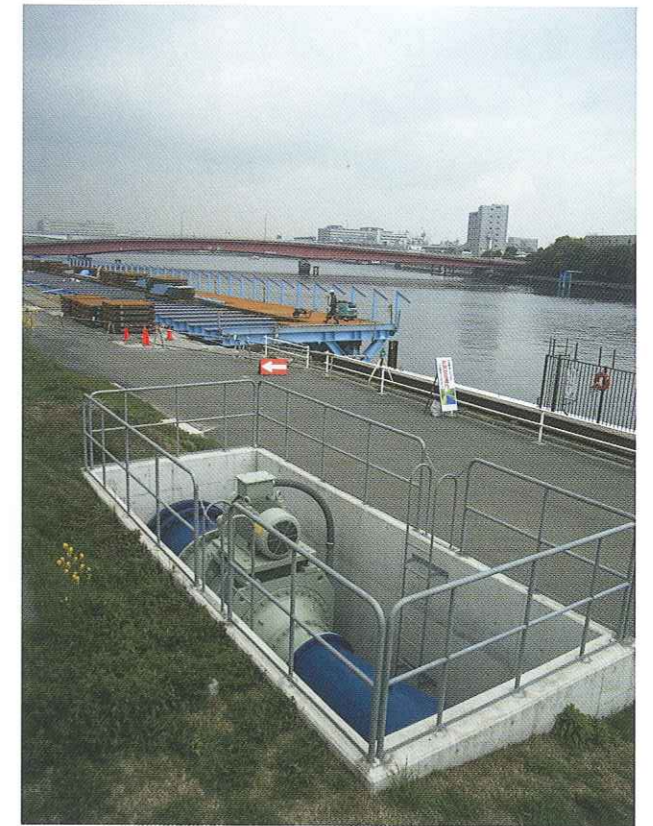
定格 110kW の水車。 目の前の東京湾に放流している。
