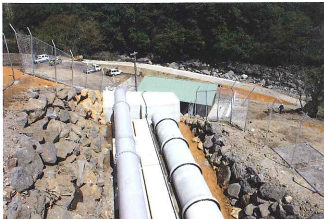
水圧鉄管 (右は余水路)
