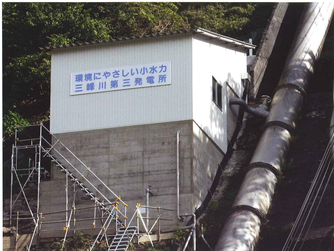
水圧鉄管を分岐し、260kW 発電の三峰川第三発電所
