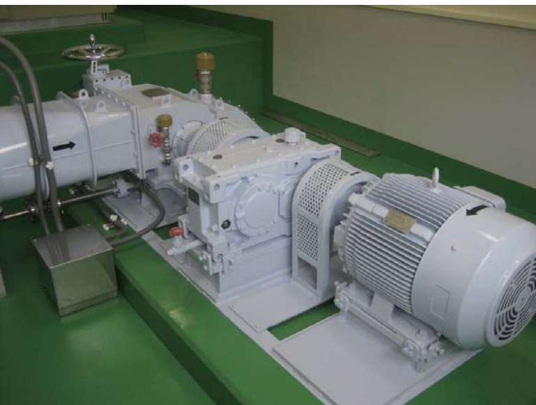
【写真4】 水車と発電機 別角度
