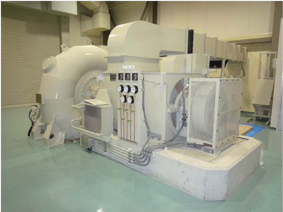
【写真2】 水車と発電機
