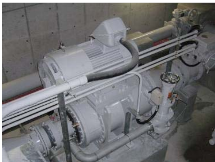
【写真2】 水車と発電機 別角度
