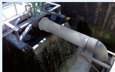
下水処理場 放流渠に設置
