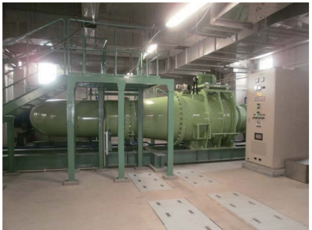
【写真2】 水車と発電機裏側から見た写真。上に乗っているのが、発電機。
