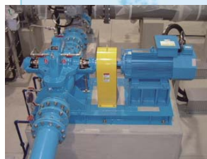
配水池 前段に設置
