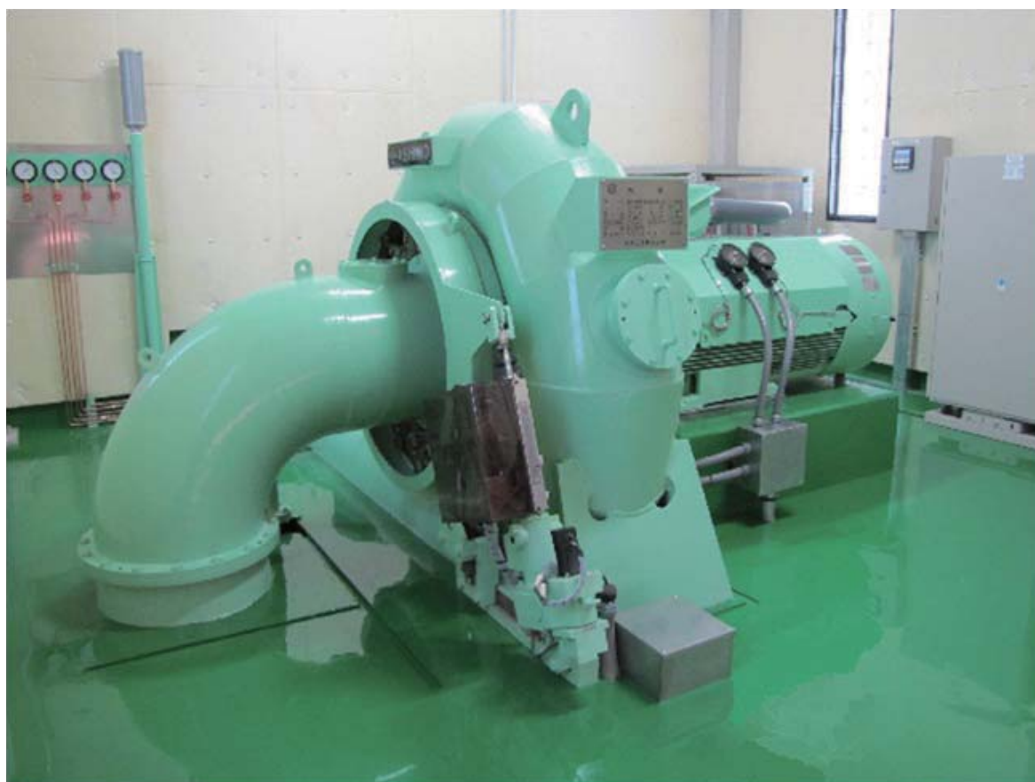
【写真1】 水車と発電機
