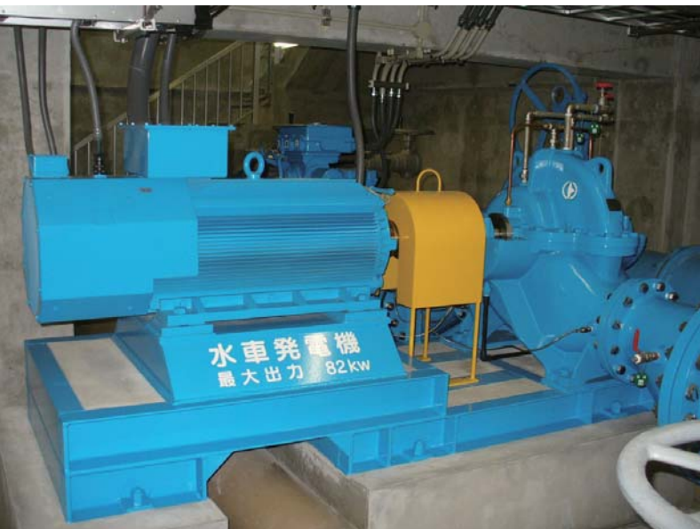
【写真1】 水車と発電機
