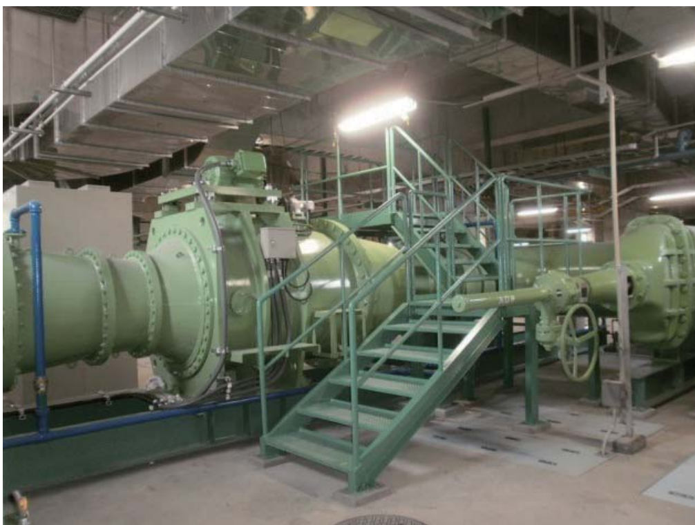
【写真1】 水車と発電機 階段左の太くなっている部分が水車
