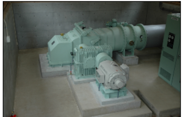
220kW クロスフロー水車・発電機
