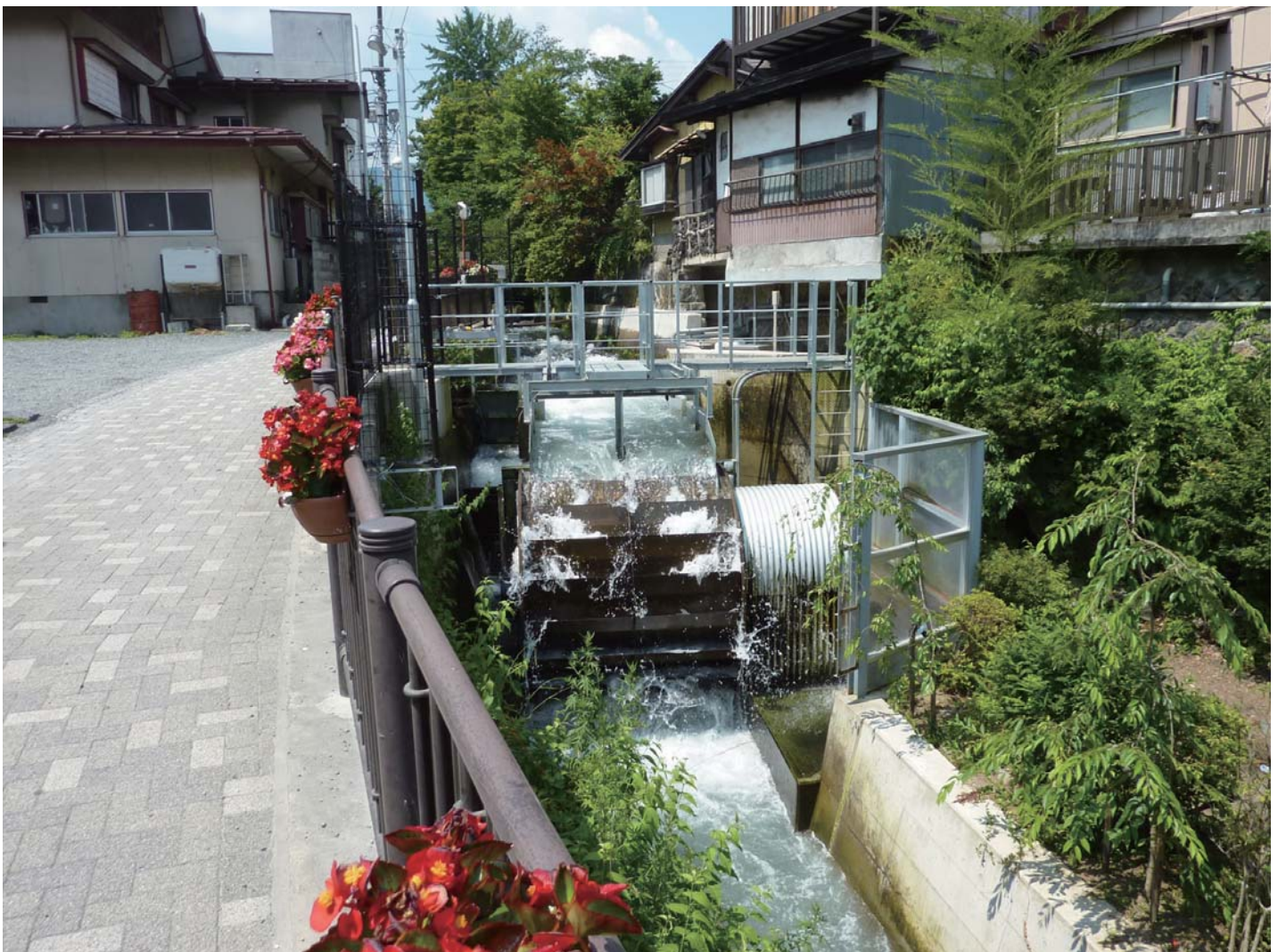
【写真1】 発電所全景
