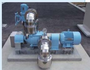
浄水場 着水井前段に設置
