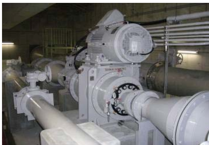
【写真1】 水車と発電機
