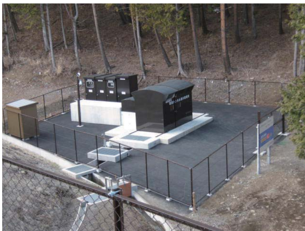
【写真3】 発電所全景
