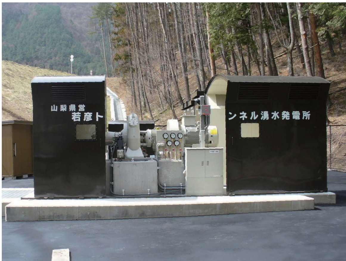
【写真1】 水車と発電機 建屋は、開閉式になっている。
