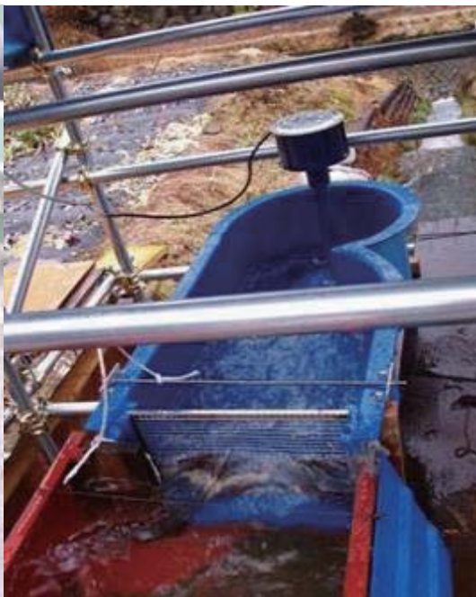
【写真3】プロペラ水車 (パワーパル・0.5kW)
