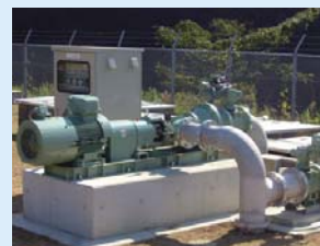
浄水場 着水井前段に設置
