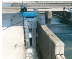
近畿地方整備局 大阪府淀川（一級河川） 毛馬水門 呼び水水路
