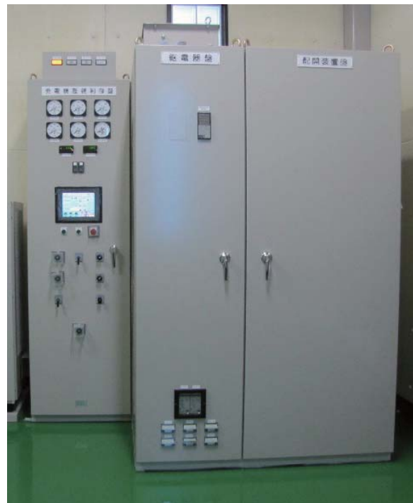
【写真3】 発電所の管理機器
